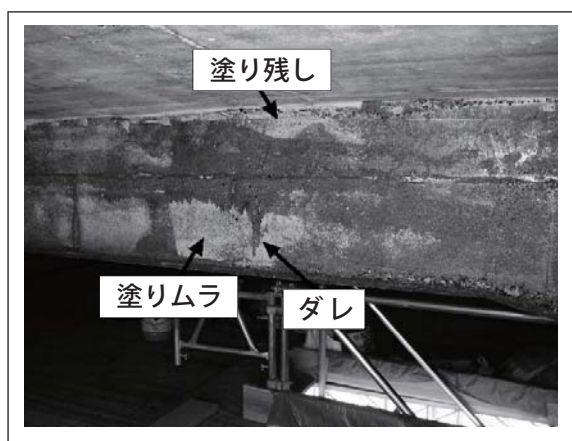
写真 2 施工不良の例
